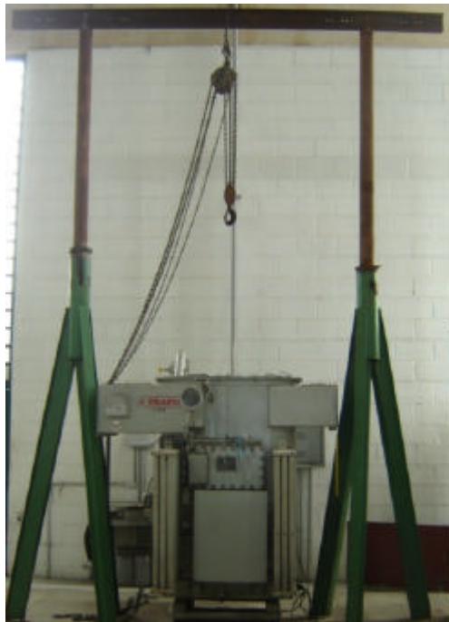
Figura 6.14 – Transformador 750 kVA, 13,8/0,48 kV utilizado nos testes de afrouxamento de enrolamentos.
