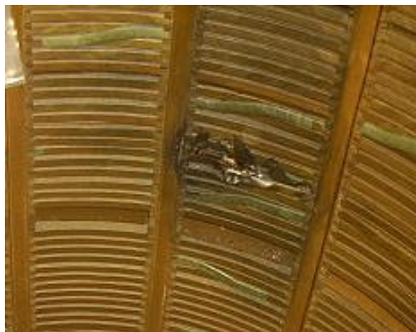
Figura 5.4 – Curto-circuito entre espiras.
