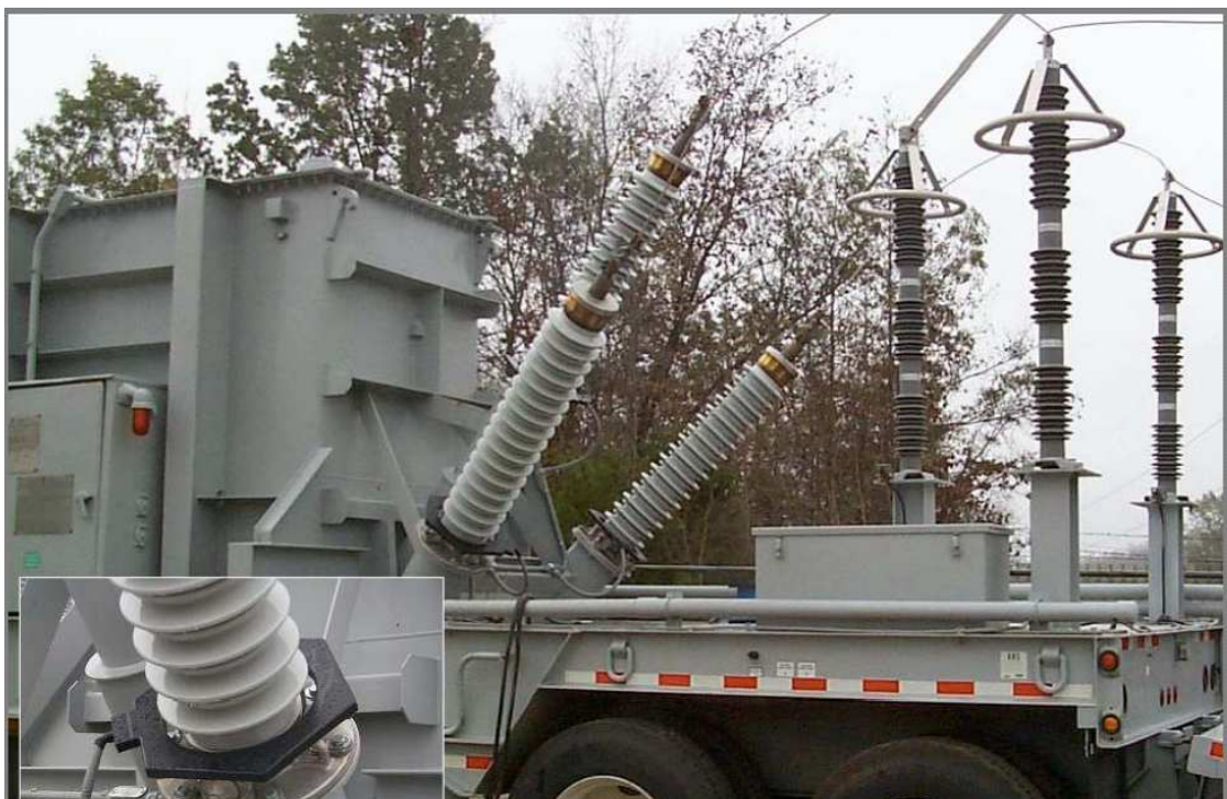
Figura 2.34 – Subestação móvel. Medição de corrente no primário [34].
